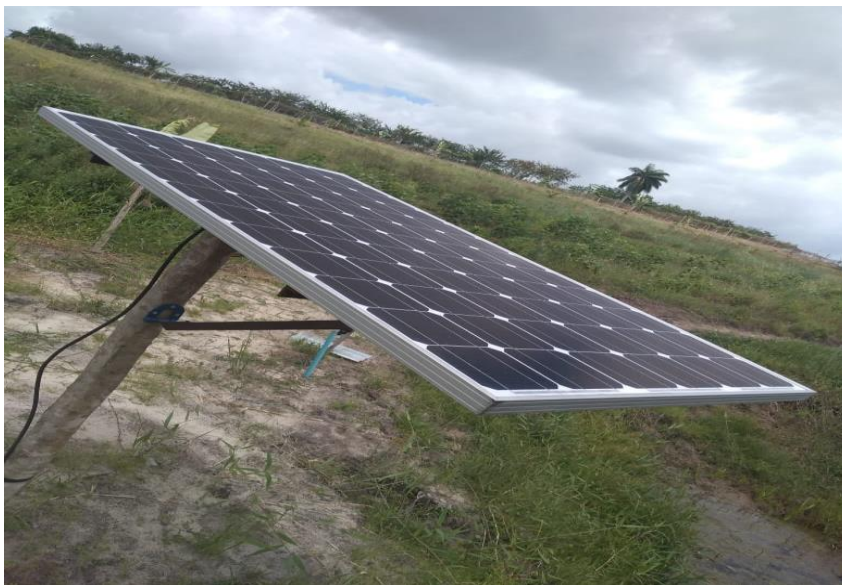
Figura 3 - Placa solar instalada em uma plantação em Rio Tinto - PB Fonte: Autores, (2021).
